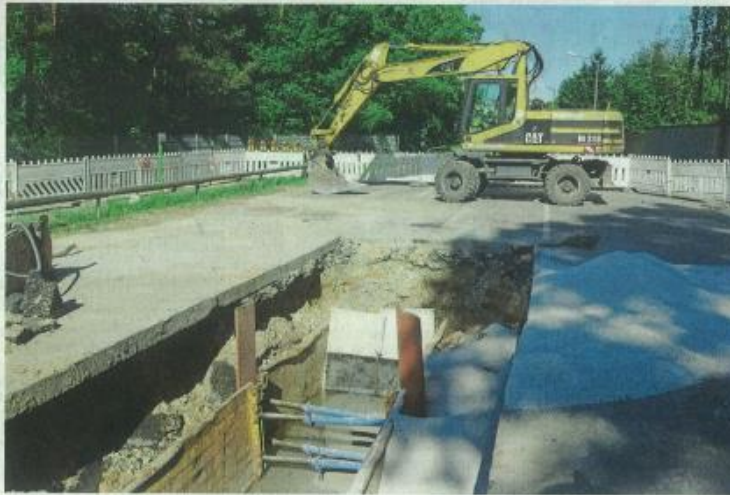
Ein Wasserrohrbruch in der Allersberger Straße führte dazu, dass Teile der Straße unterspült wurden. Bis die Schäden beseitigt sind, ist der betroffene Bereich für den Verkehr gesperrt. Foto: Gsänger
